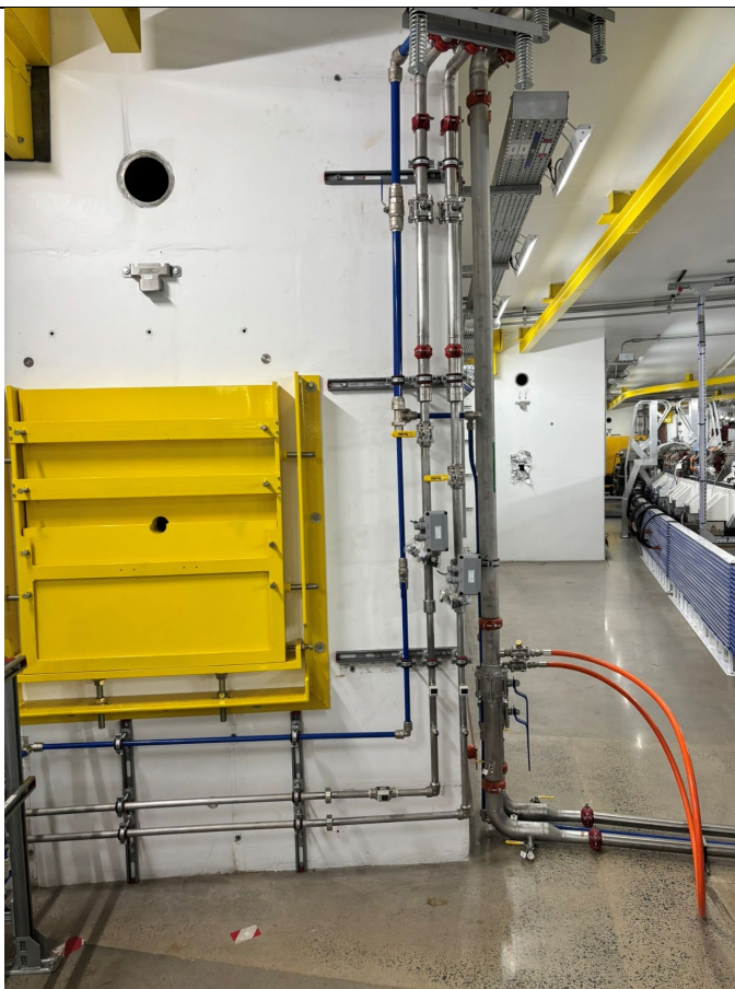
Figura 1: Vista geral da área de instalação no túnel, com infraestrutura ao longo do trecho (incluindo rotas de cabos e elementos associados) e equipamentos próximos ao alinhamento previsto para o frontend
