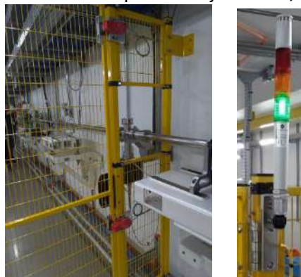
Figura 24 - Monitoramento e sinalização dos gradis internos
