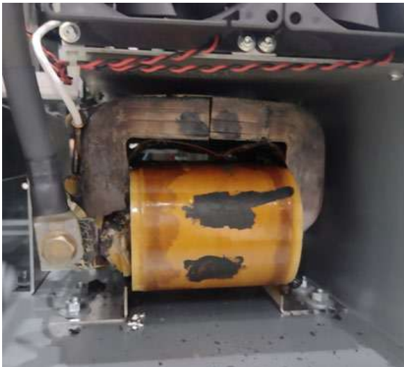
Figura 17 - Indutor de saída da Regatron após evento de queima. Após a substituição por uma unidade reserva, o funcionamento foi restabelecido, e a falha foi atribuída diretamente ao componente indutivo.
