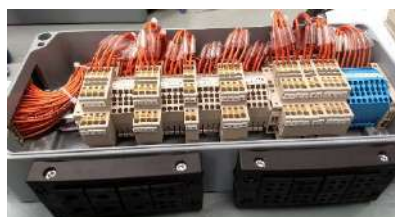
Figura 23 - Imagem interna da caixa de passagem PPS
