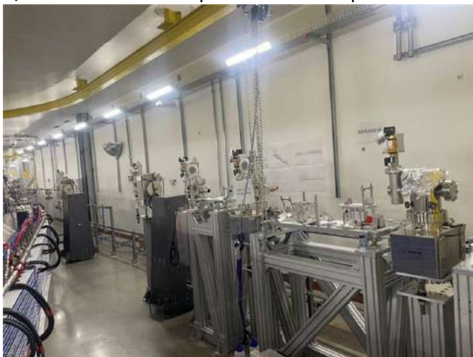
Figura 1 – Vista geral do frontend instalado no túnel do Sirius.
