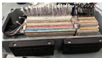
Figura 22 - Imagem interna da caixa de passagem MPS
