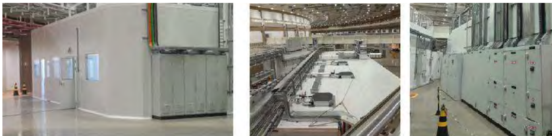
Figura 127: A cabana instalada à esquerda, sistema de ar-condicionado HVAC e sistema de EPS, PPS e quadro de distribuição de 220V, 220V UPS e 380V, na foto à direita.
