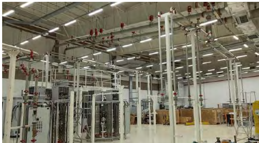
Figura 508: Circuito de processo C3 estendido na sala de RF
