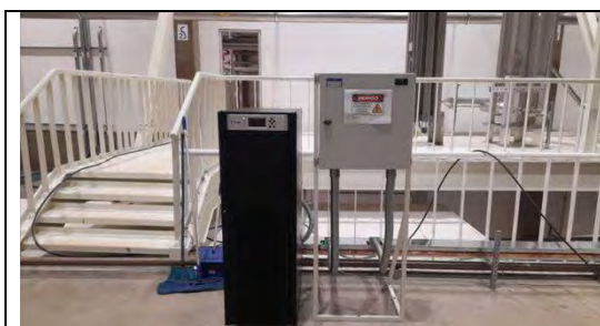
Figura 503: UPS e Painel Elétrico da Planta Criogênica
