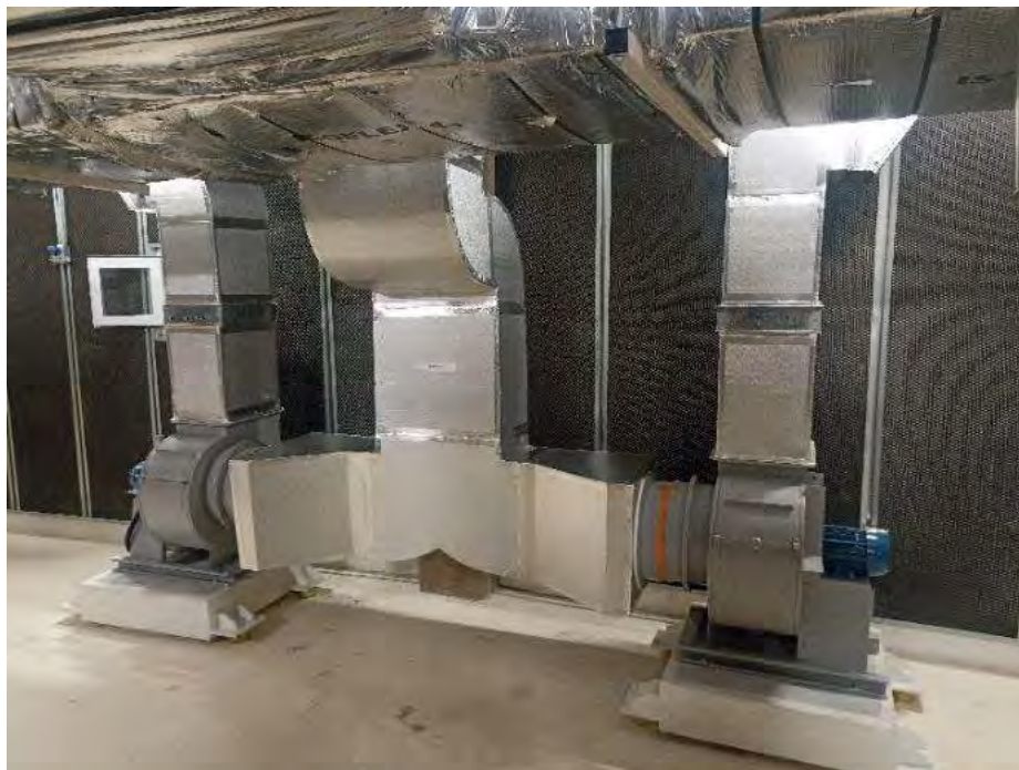
Figura 513: Ventilador de Renovação de ar (operante + reserva)
