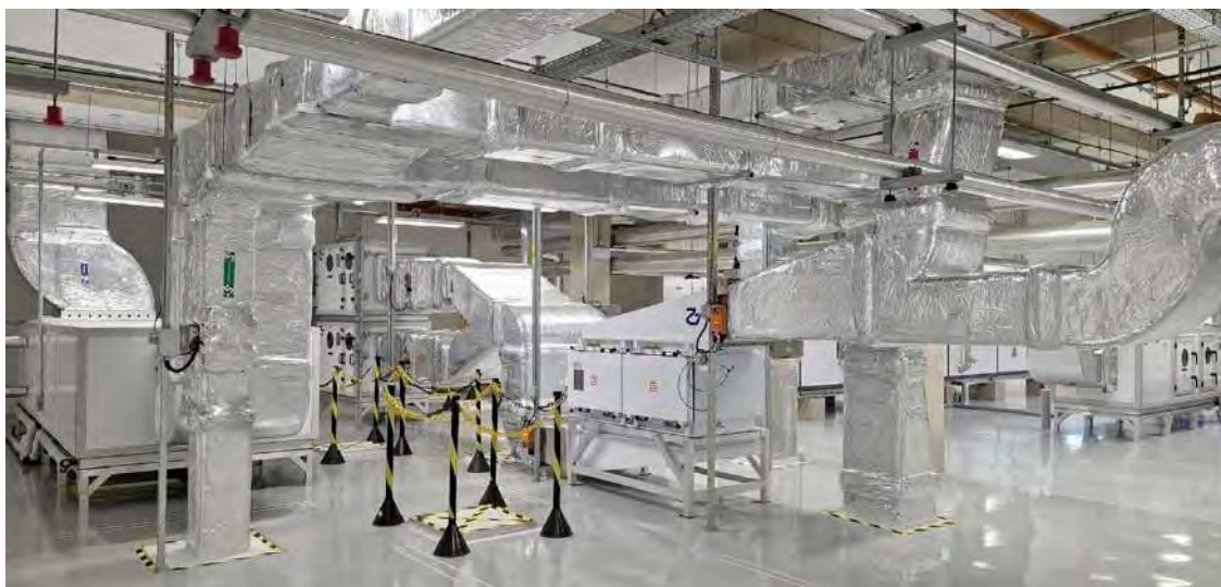
Figura 240. Área Técnica do NB3. Área com as tubulações, filtros e ventiladores para filtrar o ar e manter as pressões nos ambientes laboratoriais.
