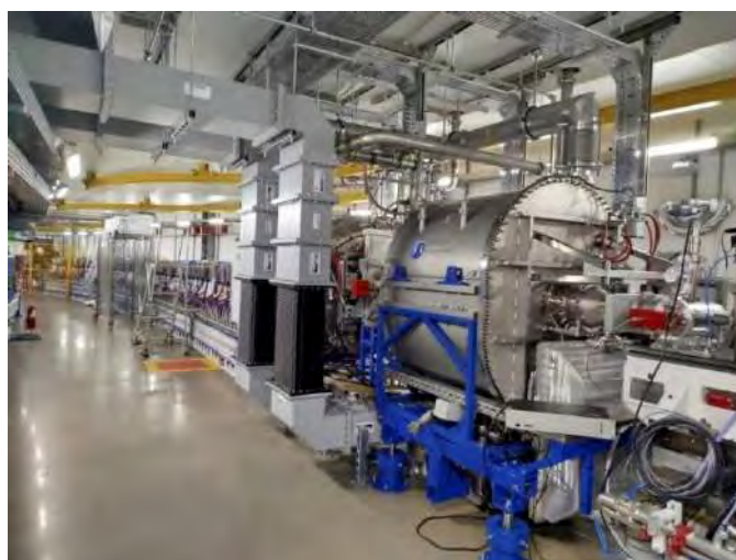
Figura 109: Instalações das duas cavidades supercondutoras
