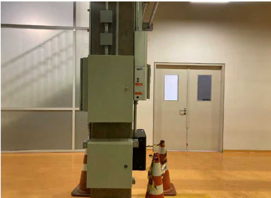
Figura 547: Quadro de módulos, isoladores e caixa de bateria instalados para atender um dos equipamentos VEA do sistema de detecção
