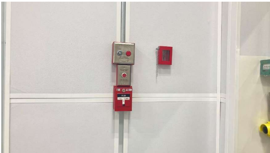
Figura 538: Equipamentos de ação manual do sistema de combate instalados no ambiente do laboratório de microscopia (LAM)
