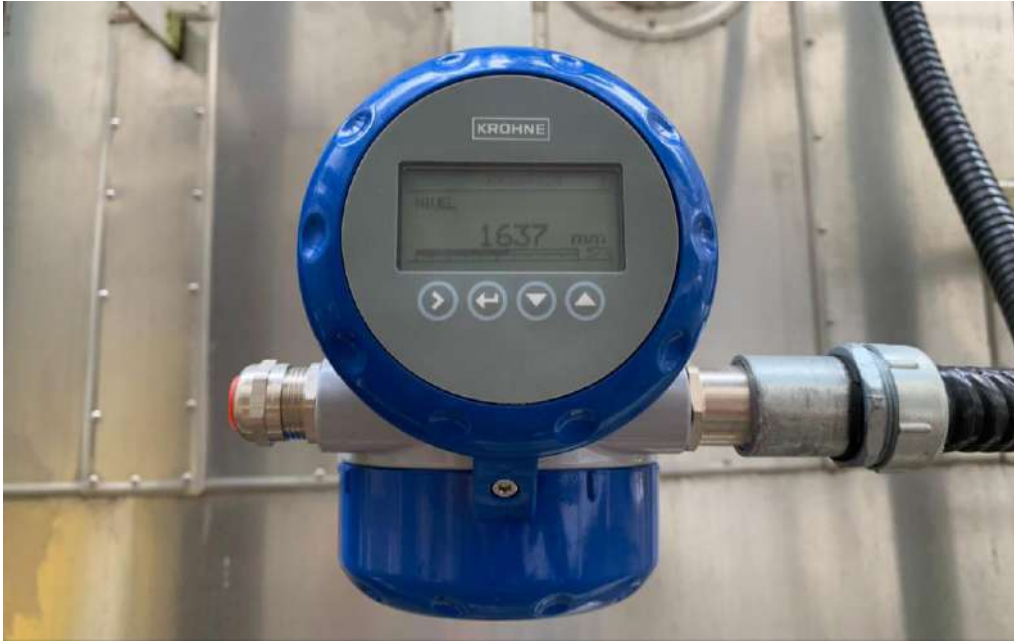
Figura 543: Inserido sensor de nível nos tanques de termoacumulação
