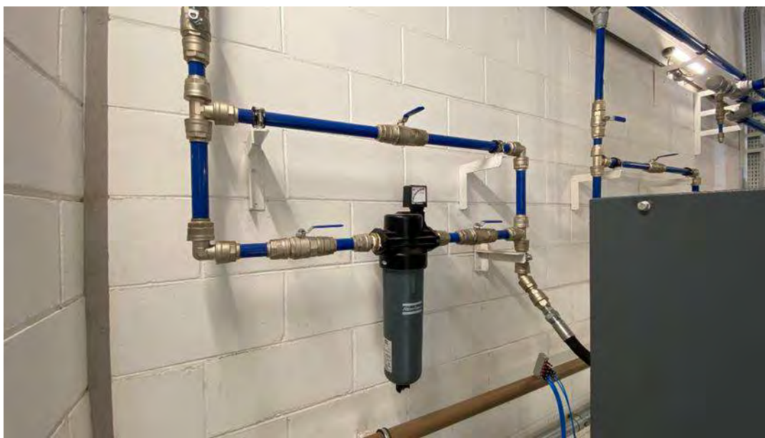
Figura 553: Cavalete padrão dos compressores.
