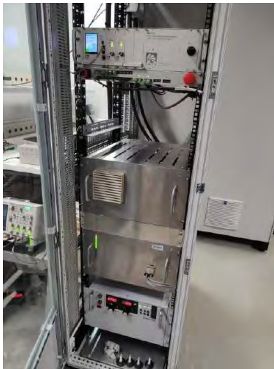
Figura 393: Fonte montada no rack em conjunto com o sistema de controle do SWLS.
