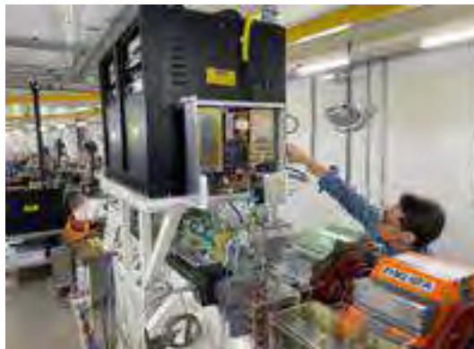
Figura 34: Bastidor modificado para operação Full-Sine em 1,2 kV
