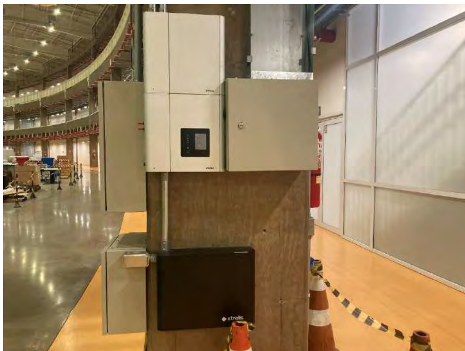
Figura 548: Fonte, VEA e Stax instalados para atender o sistema de detecção das linhas de luz do Sirius
