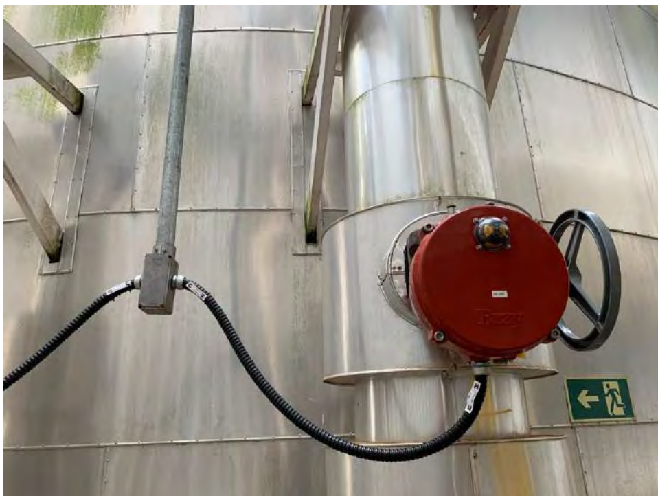
Figura 542: Atuadores dos chillers e tanques instalados após revisão do equipamento e do seu cabeamento
