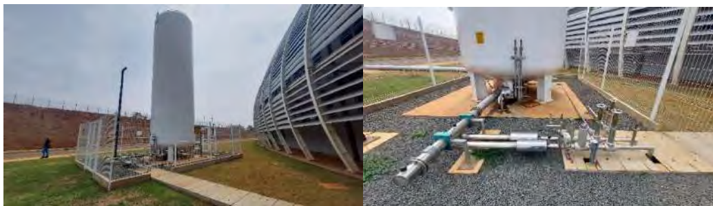
Figura 524: Tanque de Nitrogênio e linhas de distribuição
