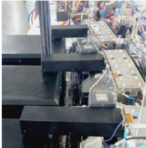
Figura 39: Blindagem magnética na conexão de potência.
