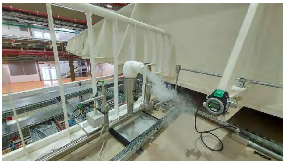
Figura 528: Transdutores de pressão, temperatura, degasser e válvula de setor
