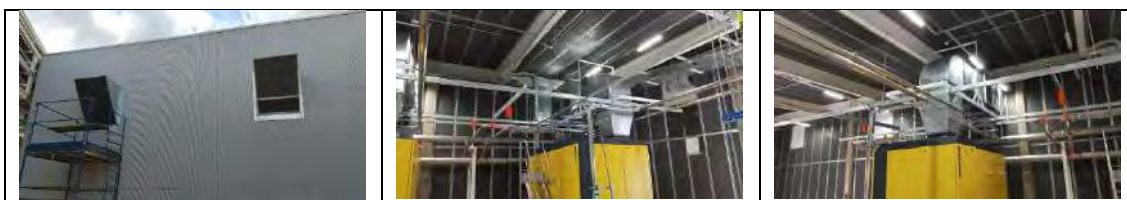
Figura 507: Exaustão dos Compressores de Hélio
