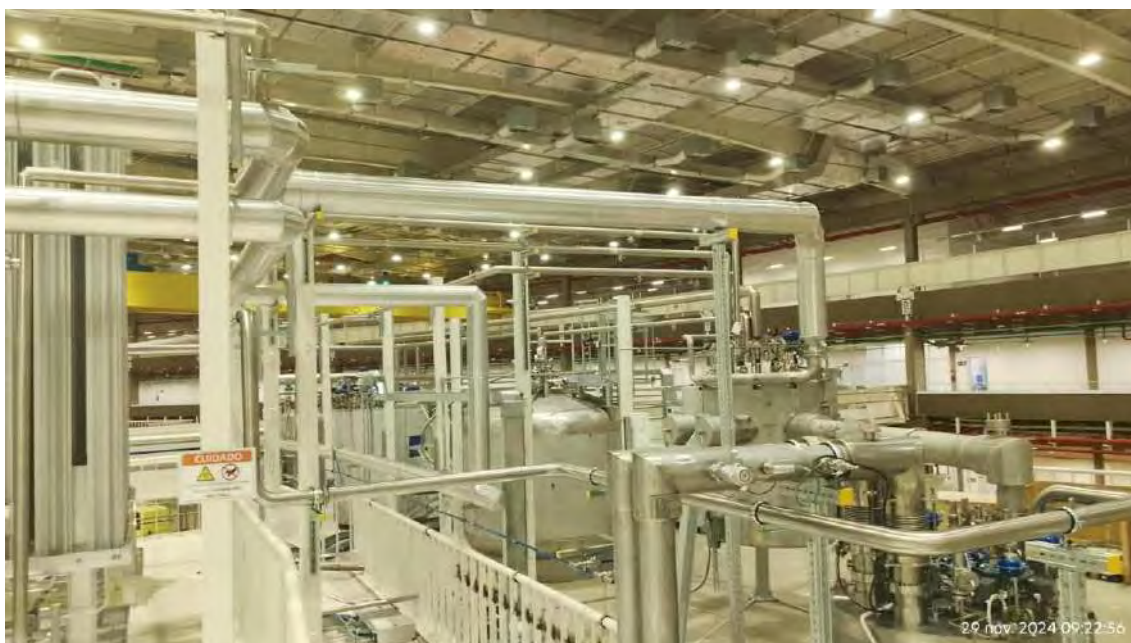
Figura 516: Exaustão das válvulas de segurança da Manifold Box
