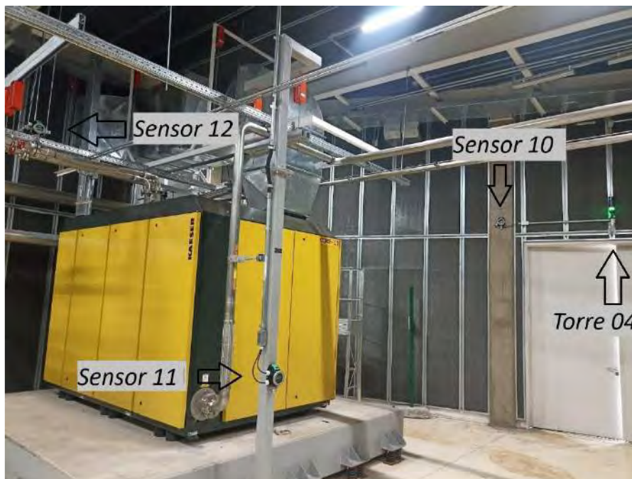
Figura 515: Posição dos sensores de O 2 na sala de compressores de hélio.
