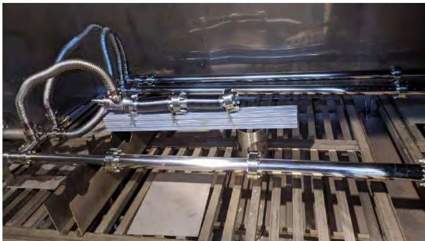
Figura 488: Câmaras de aço inoxidável condicionadas e prontas para instalação.
