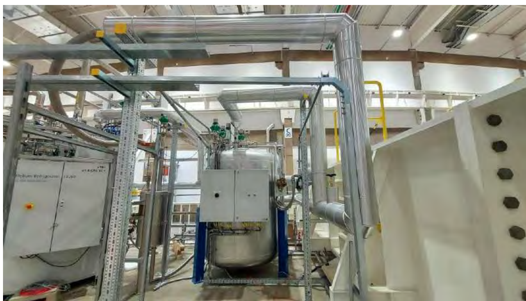
Figura 526: Separador de fases instalado
