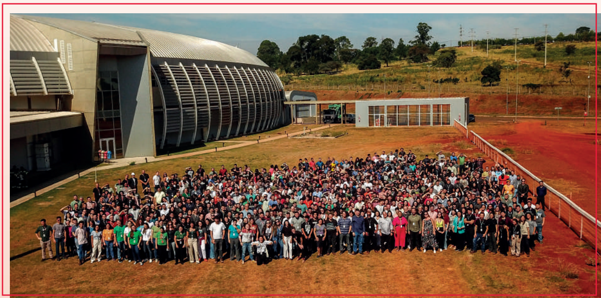
Registro Fotográfico reuniu colaboradores de todo CNPEM para marcar o início das escavações no terreno do Orion
