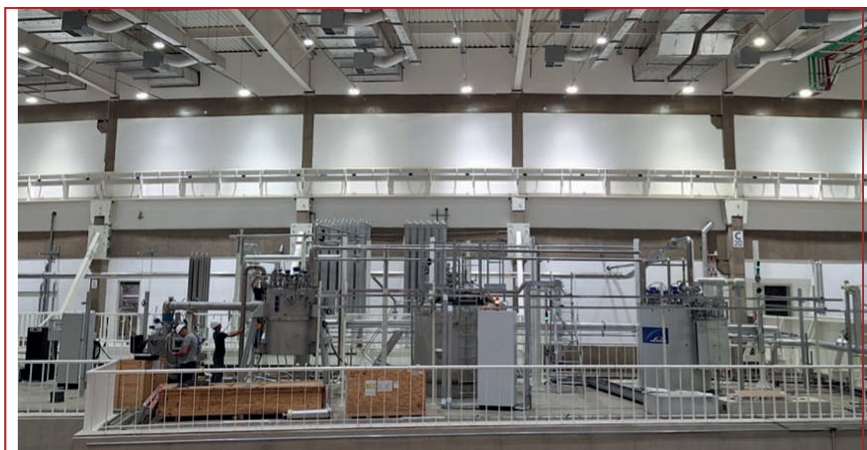
Figura 55: Parte Fria da Planta Criogênica instalada no Hall Experimental
