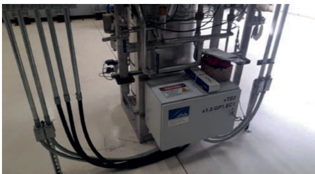
Figura 92. Painel TB2 Energizado
