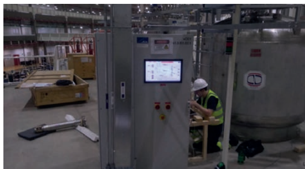
Figura 91. Painel CC1 energizado
