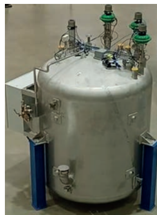
Figura 97. Separador de fases removido para envio para retrabalho na DEMACO
