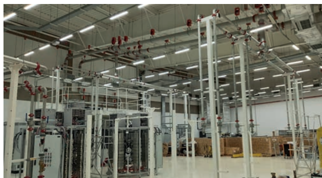
Figura 95. Circuito de processo C3 estendido na sala de RF
