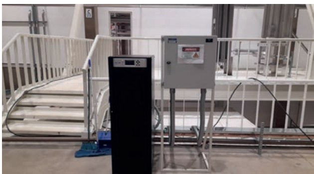
Figura 90. UPS e Painel Elétrico da Planta Criogênica
