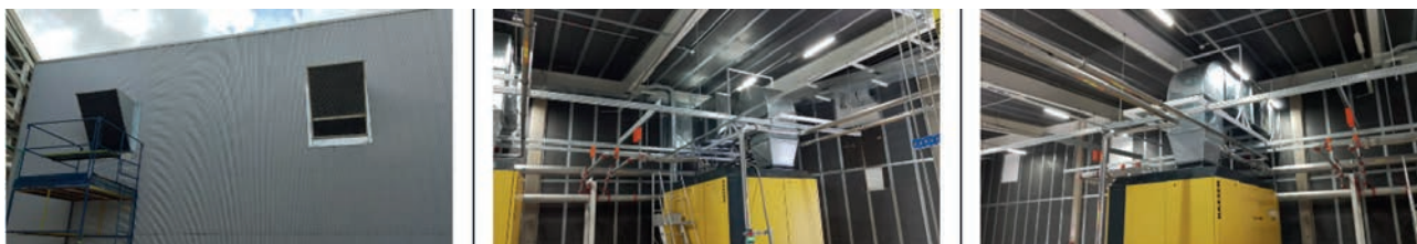
Figura 94. Exaustão dos Compressores de hélio
