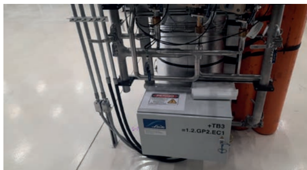
Figura 93. Painel TB3 Energizado
