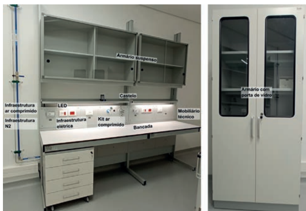
Figura 126: Mobiliário técnico instalado no Laboratório de Microtomia (LMT), integrado à infraestrutura de gases e elétrica, permitindo o uso de LEDs, tomadas e gases na bancada de trabalho para a preparação e manipulação de amostras.
