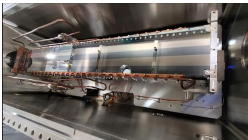
Figura 3 – Espelho M1 da linha QUATI no dia da instalação, antes do fechamento da câmara.
