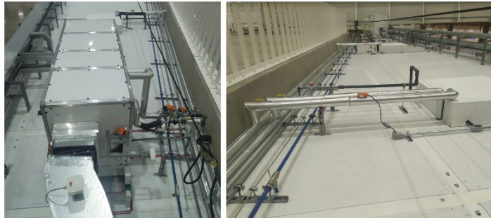
Figura 2 - Ar condicionado HVAC
