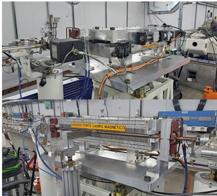
Figura 6 - Ondulador PAPU instalado para linha SAPUCAIA
