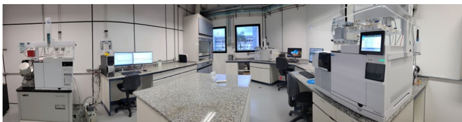
Figura 6: Sala de espectrometria de massas à cromatografia gasosa após a reforma , com melhorias no sistema de gases e de controle de temperatura e com o novo espectrômetro de massas já instalado (os dois equipamentos da direita no fundo da sala).
