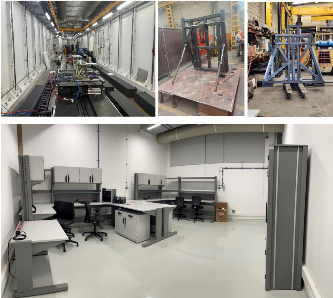
Figura 94: Instalações da microestação e da sala de apoio da Mogno
