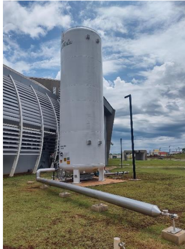
Figura 366. Tanque de Nitrogênio instalado
