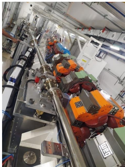
Figura 345. FEBC instalado - Linha Mogno
