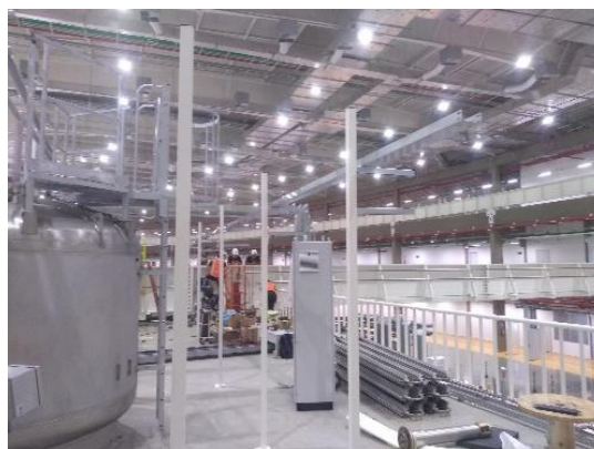
Figura 382. Infraestrutura elétrica do quadro CC1.
