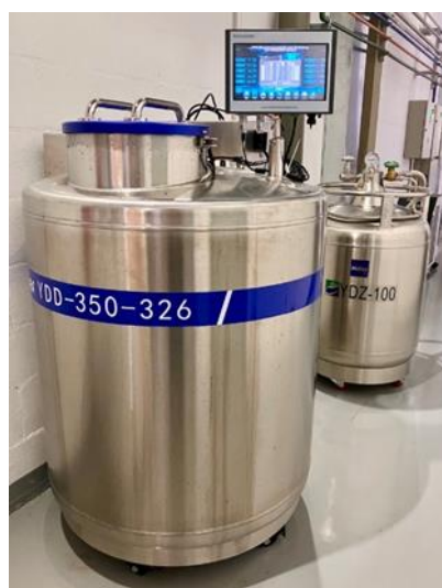
Figura 263. Tanque YDD-350-326 (Haier), para o armazenamento de amostras criogênicas, instalado e operante
