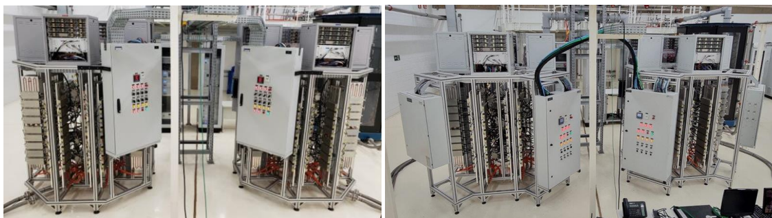
Figura 77: Torres de RF do primeiro lote (esq.) e do último lote (dir.) em operação.
