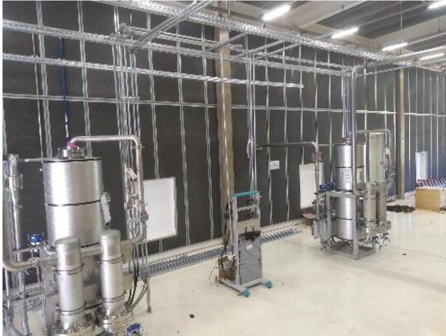
Figura 383. Infraestrutura elétrica do analisador de gases.
