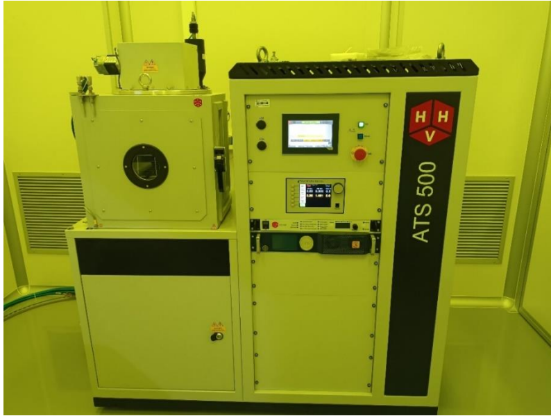
Figura 258. Sputtering HHV modelo ATS500 instalado na sala limpa de Nanofabricação
