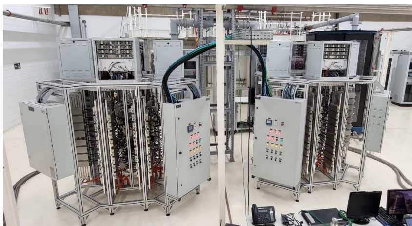
Figura 302. Novos amplificadores de RF instalados no sistema de RF atual do Sirius
