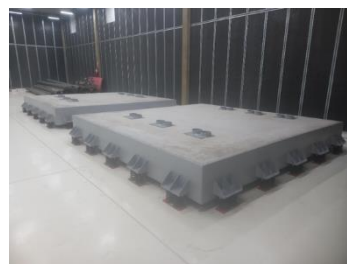
Base Inercial dos Compressores
