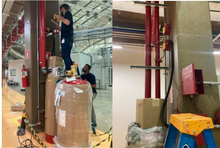
Figura 384. Instalação de cilindros de agente extintor que atendem a sala do CPD e sua casa de máquinas
