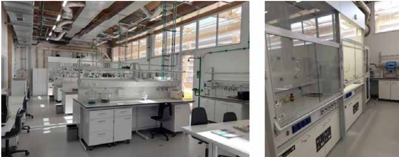
Figura 91: Infraestrutura aberta (esquerda); capelas de exaustão em operação (direita).
