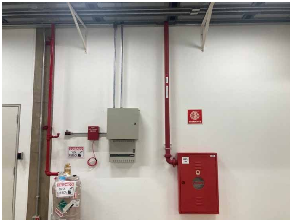
Figura 52 - Cilindro, tubulação e equipamentos instalados para a sala Microscopia
