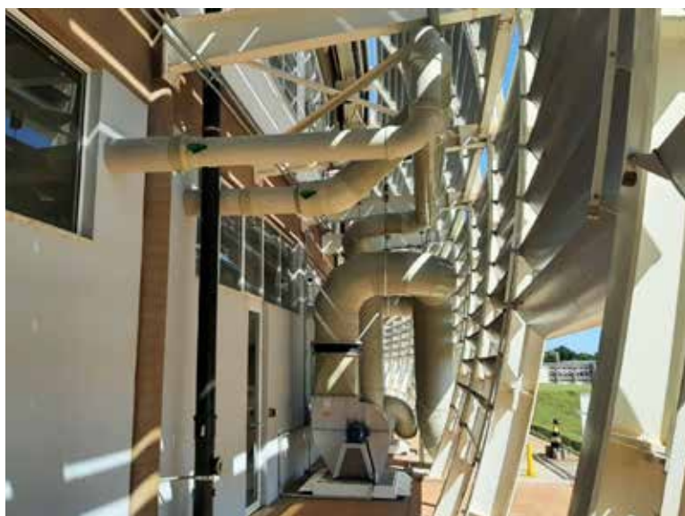
Figura 50 - Sistema de exaustão dos laboratórios LQ, LCIS e LMS.
