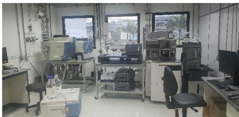
Figura 306. Sala de espectrometria de massas à cromatografia líquida após a reforma, com melhorias no sistema de gases e de controle de temperatura e com o novo espectrômetro de massas já instalado (os dois equipamentos da direita no fundo da sala).
