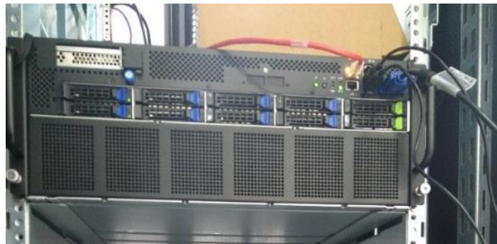
Figura 55 – Novo Servidor ATOS instalado no laboratório do grupo de detectores para os testes de homologação.
