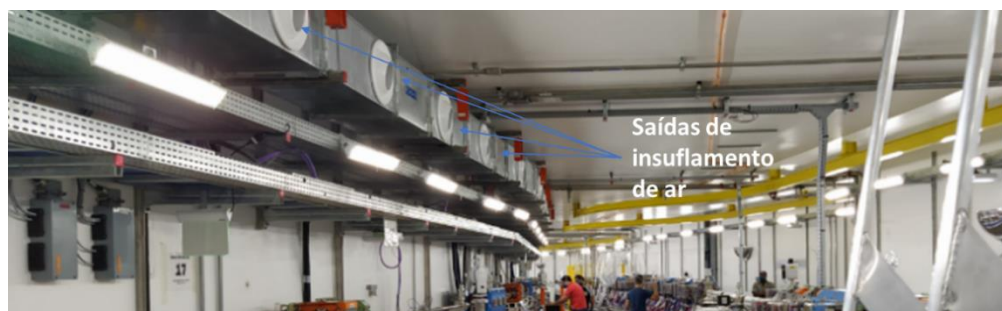
Figura 530 – Dutos de insuflamento de ar do sistema de ar-condicionado do túnel dos aceleradores.
