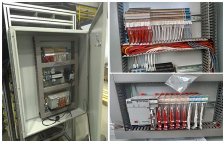
Figura 400 – Painel de intertravamento da torre (esquerda) e detalhes da montagem interna (direita).
