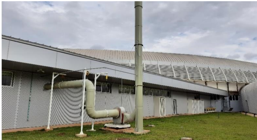
Figura 451 – Ventilador de Exaustão e chaminé dos Laboratórios do S9
