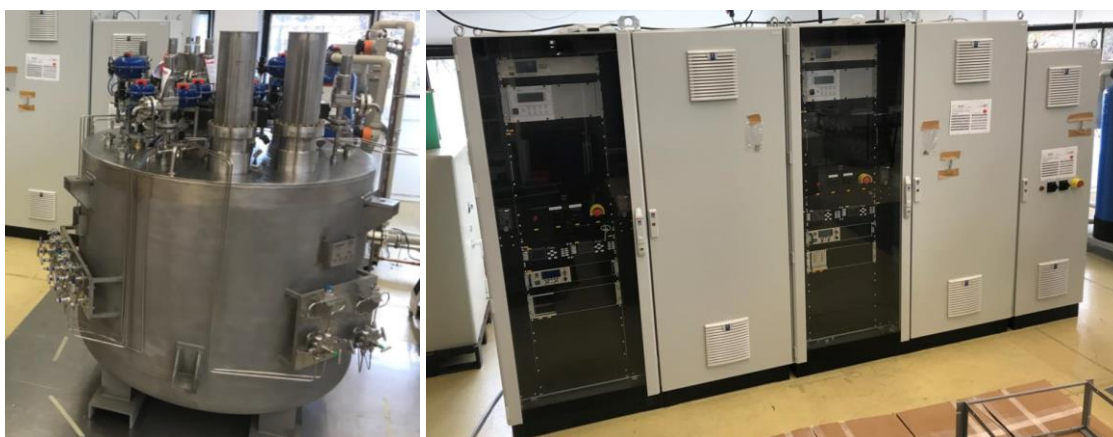
Figura 388 – (Esquerda) Valve box para o controle de fluxo de hélio dos dois criomódulos das cavidades supercondutoras do Sirius; (Direita) Racks de controle dos criomódulos e da valve box.
