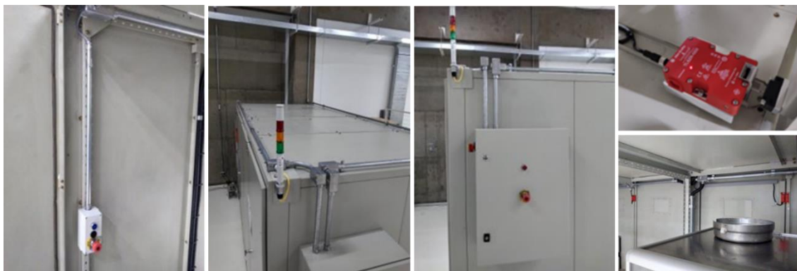
Figura 552 – Instalação de campo do sistema de segurança da bancada de teste do canhão do Sirius. Detalhes das botoeiras, da instalação do painel de controle, dos sensores e chave de segurança mostrados nas diversas fotos.
