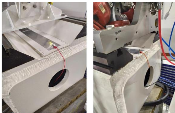
Figura 523 – Sensores de vazamento para pequenos volumes de água instalados nos berços do setor 3 do anel de armazenamento.
