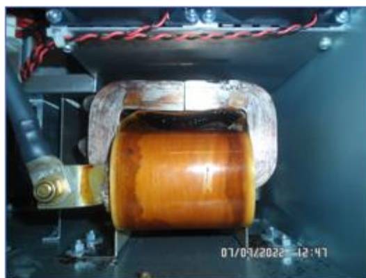
Figura 515 – Indutor da fonte comercial Regatron apresentando sinais de sobreaquecimento.
