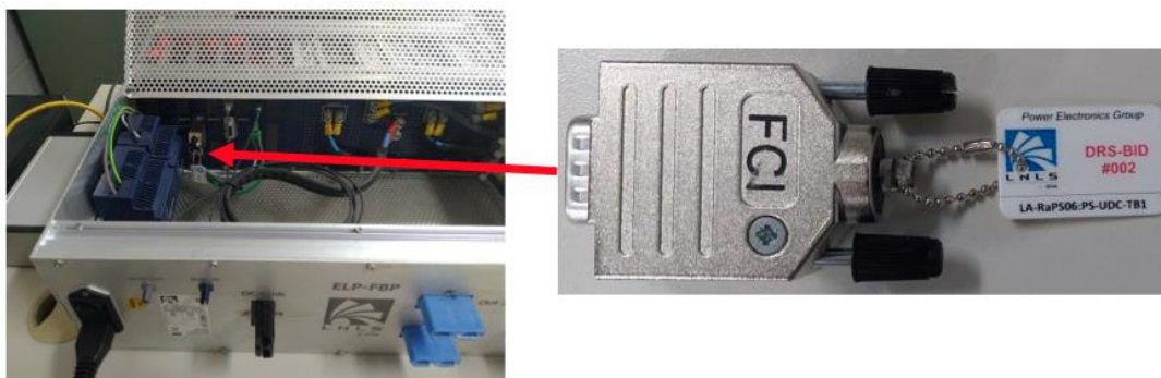
Figura 507 – Placa BID (direita) com banco de parâmetros individual das fontes do Sirius. As placas são instaladas diretamente em cada bastidor (esquerda) e isso permite que qualquer controlador quando se reinicie carregue as informações necessárias para o correto funcionamento sem necessidade de intervenção manual.
