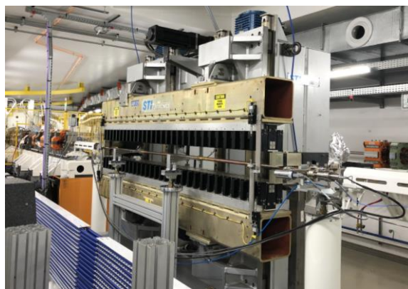
Figura 424 – Wiggler de 2 Tesla instalado no trecho 14 do anel de armazenamento do Sirius.
