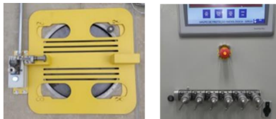
Figura 517 – Mecanismos de bloqueio e monitoramento das aberturas das linhas de visada (esquerda) e sistema de Trapped-Key para controle e liberação das aberturas das linhas de visada no painel de interlock da sala de controle.
