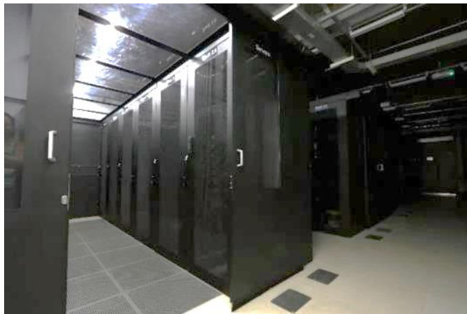
Figura 65 - Instalação TEPUI UI: 3 Ilhas principais, dedicadas à processamento, redes e armazenamento de dados.
