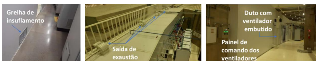
Figura 529 – Protótipo para redução de temperatura das salas de rack baseado em insuflamento de ar frio do hall experimental.
