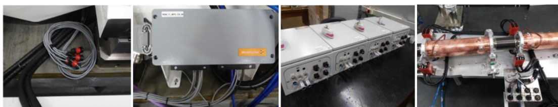
Figura 519 – Da esquerda para direita: cabos de interligação e controle para front-ends (esquerda), exemplo de nova caixa de passagem instalada no interior dos aceleradores do Sirius, novos painéis pneumáticos instalados para os front-ends e cabos de sinal já conectorizados para operarem junto a um front-end máquina sob testes (direita).
