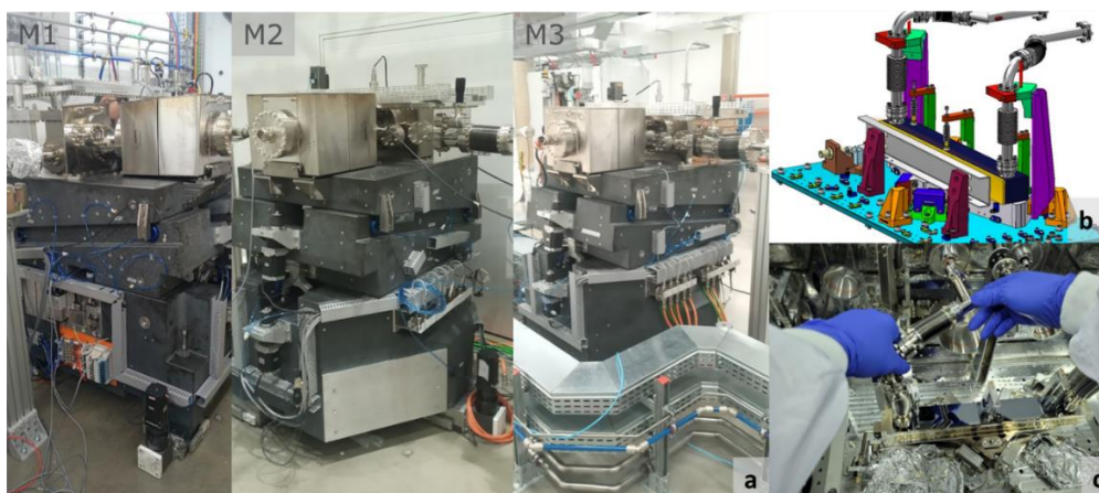
Figura 21: Espelhos instalados na linha SABIÁ durante fase de roteamento de cabos (a), representação em CAD do espelho M1 (b) e fotografia durante montagem de mangueiras de refrigeração do M1 (c).
