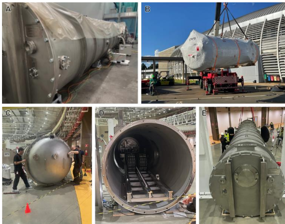
Figura 134. Imagens do túnel da linha Sapucaia. (A) Na sede da AVS, em Eigobar, Espanha, durante o teste de aceitação em novembro de 2021. (B) Túnel durante o desembarque no Sirius em março de 2022. (C-D) Fotos do túnel durante a instalação no SIRIUS em maio de 2022. A imagem D evidencia o trilho no qual o detector será movimentado com precisão micrométrica. (E) Imagem do túnel após instalação finalizada.
