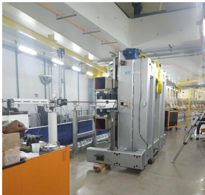
Figura 120: Wiggler de 1T instalado no anel de armazenamento do Sirius
