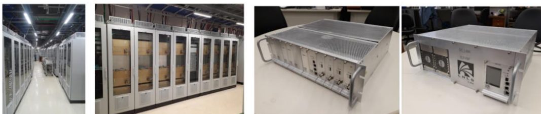
Figura 537 – Da esquerda para a direita, foto da sala de fontes (esquerda), fontes de alta potência AC do booster, bastidor de fontes de baixa potência e DC-link usado nas fontes de baixa potência (direita).
