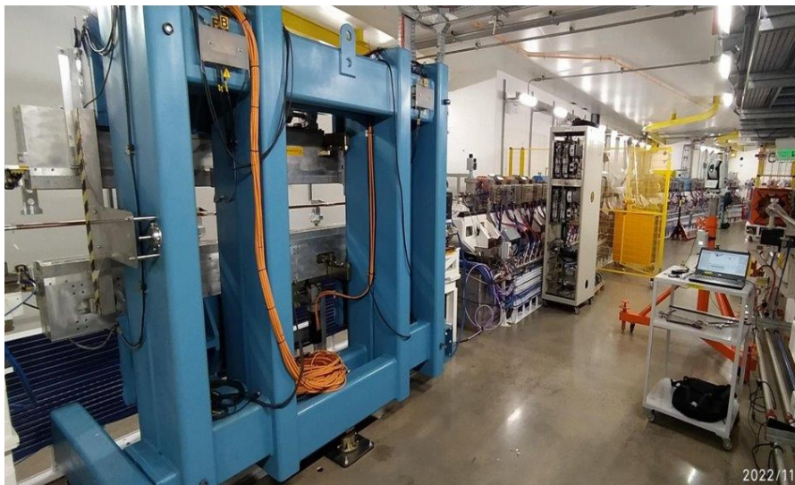
Figura 124: ondulador EPU instalado no anel de armazenamento
