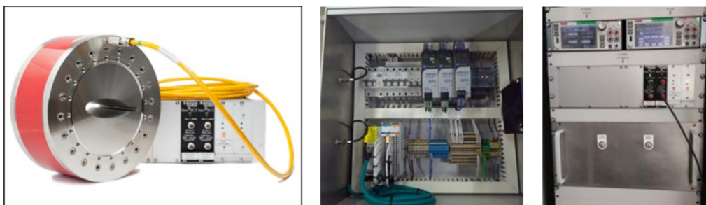
Figura 518 – Sensor NPCT para leitura da corrente armazenada no Sirius (esquerda). No Sirius, para efeito de redundância, dois sensores NPCT operam simultaneamente. Detalhe interno do novo hardware de processamento dos sinais de corrente armazenada para liberação da injeção em modo top-up (centro). Rack de instrumentação com as eletrônicas de leitura de corrente e de intertravamento que permitirão a injeção em modo top-up de forma segura em 2023 (direita).
