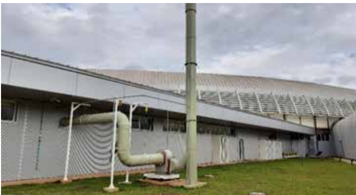
Figura 50: Ventilador de Exaustão e chaminé dos Laboratórios do S9
