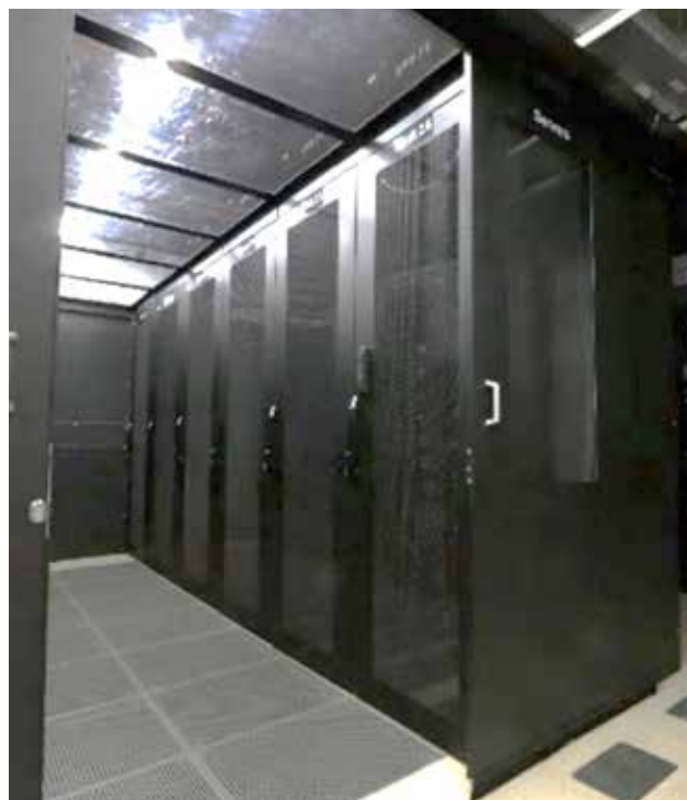
Figura 26 - Instalação TEPUI UI: 3 Ilhas principais, dedicadas à processamento, redes e armazenamento de dados.
