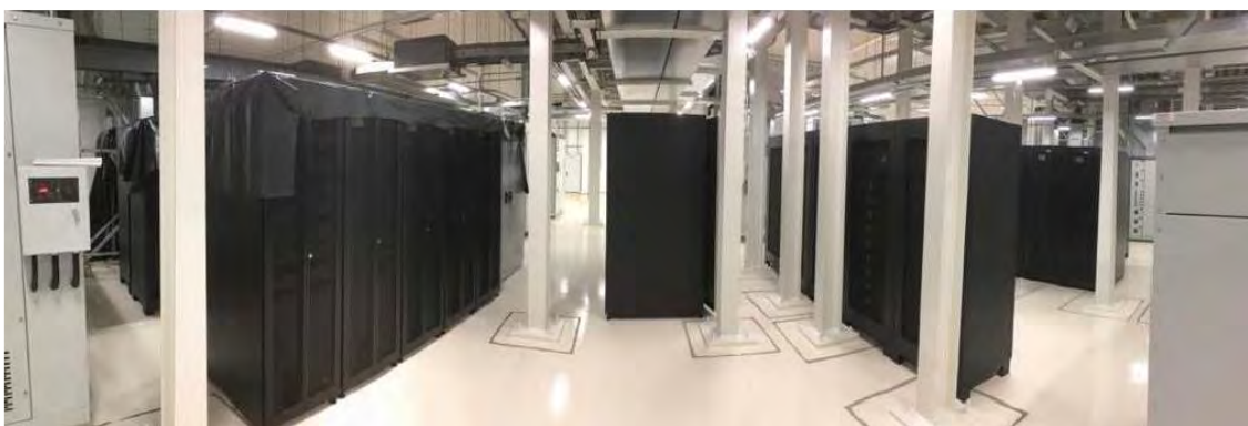
Figura 204. Racks dos UPS instalados no Sirius
