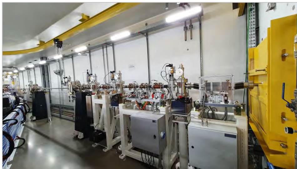
Figura 17 Front-end da linha IPÊ após o término da instalação em novembro deste ano.
